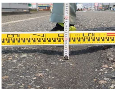
舗装のわだち掘れ
