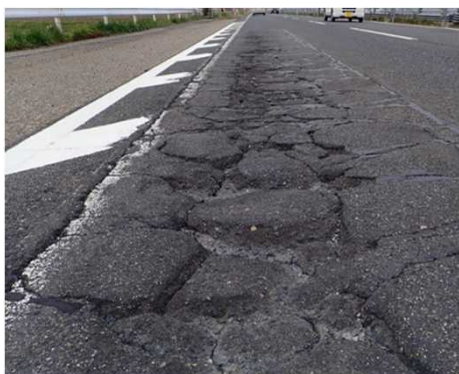
舗装のひび割れ
