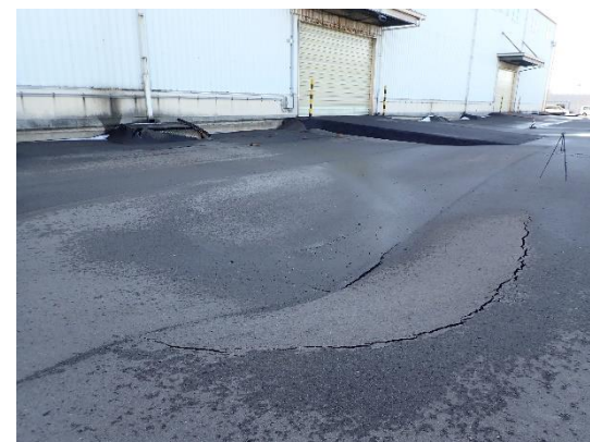
ふ頭用地陥没
