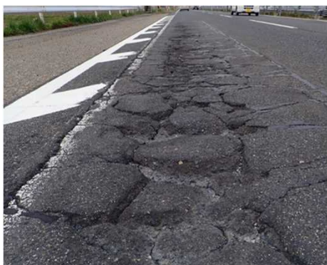
舗装のひび割れ
