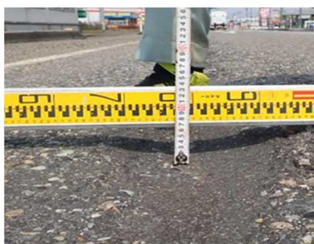
舗装のわだち掘れ
