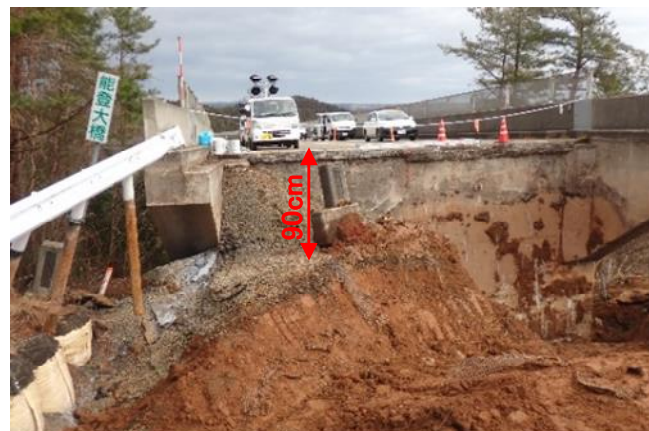
能登大橋A1橋台アプローチ部の被災状況
