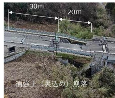
橋梁の損傷（烏川大橋）
