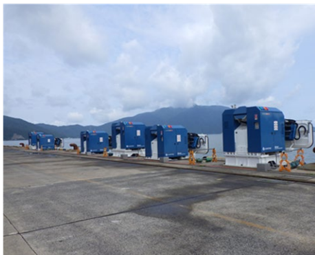
敦賀港の自動係留装置（全6基）
