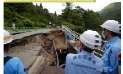
【令和4年8月の大雨】 (山形県米沢市)
