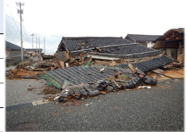
〔建物の倒壊(輪島市)〕
