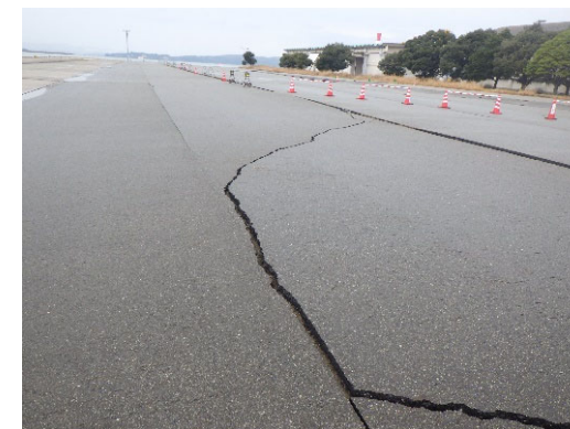
栈橋背後のクラック
