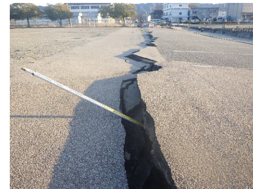
エプロン背後のクラック
