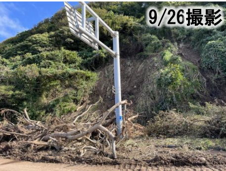
新規に被災した 切土法面崩壊 (珠洲市長橋)
