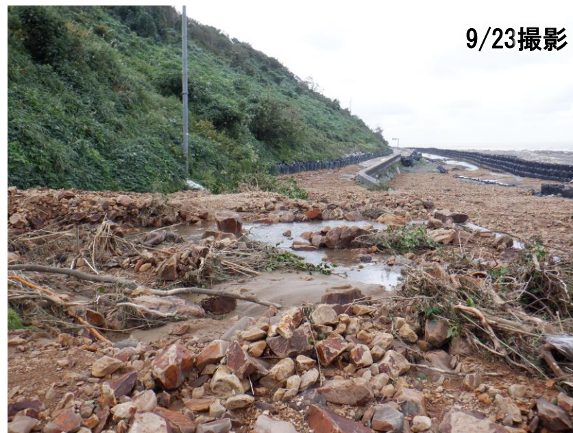
緊急復旧道路(1車線目)の土砂堆積状況
