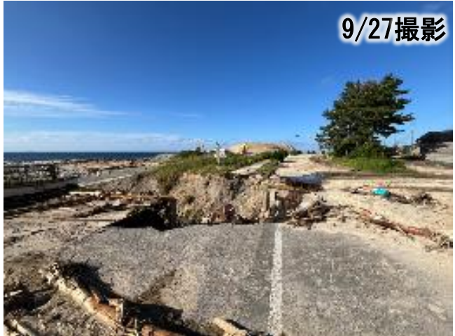
新規に被災した路面損傷 (珠洲市仁江)
