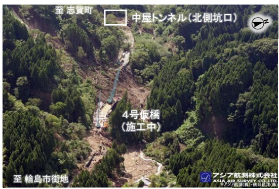
【写真】4号仮橋付近の被災状況
