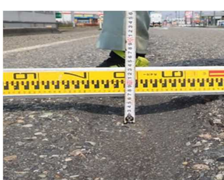
舗装のわだち掘れ
