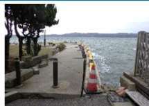
護岸の傾斜(被災後)
