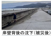
岸壁背後の沈下(被災後)
