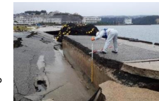
物揚場エプロン沈下(被災後)
