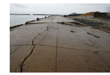
岸壁エプロン沈下(被災後)
