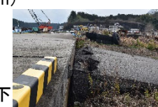
物揚場エプロン段差(被災後)
