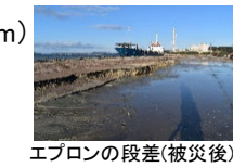
エプロンの段差(被災後)
