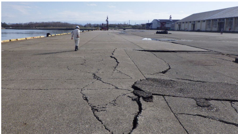
①被災状況(1/2(火)撮影)
