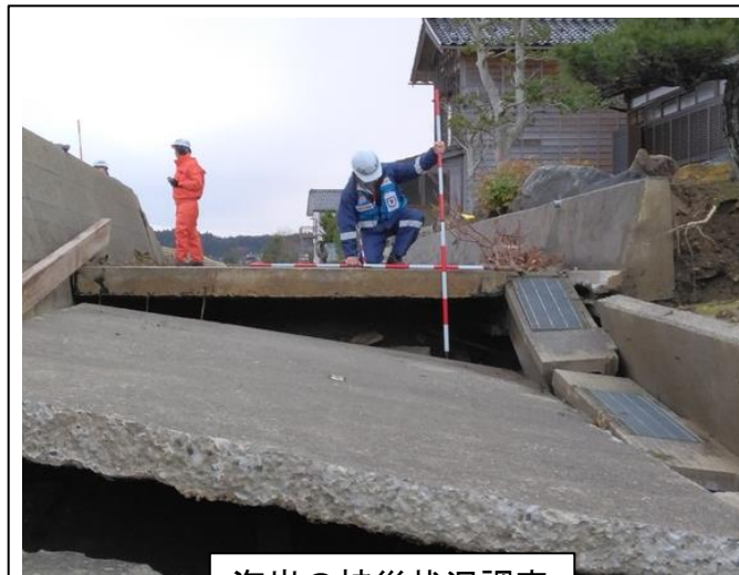
海岸の被災状況調査
