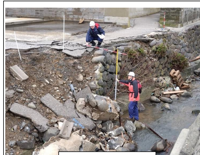
河川の被災状況調査
