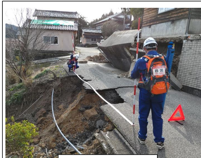
道路の被災状況調査
