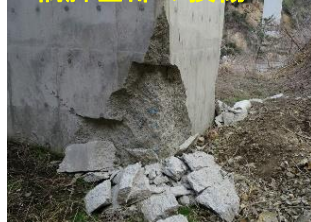
橋脚基部の損傷
