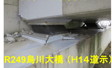
ゴム支承の残留変形
