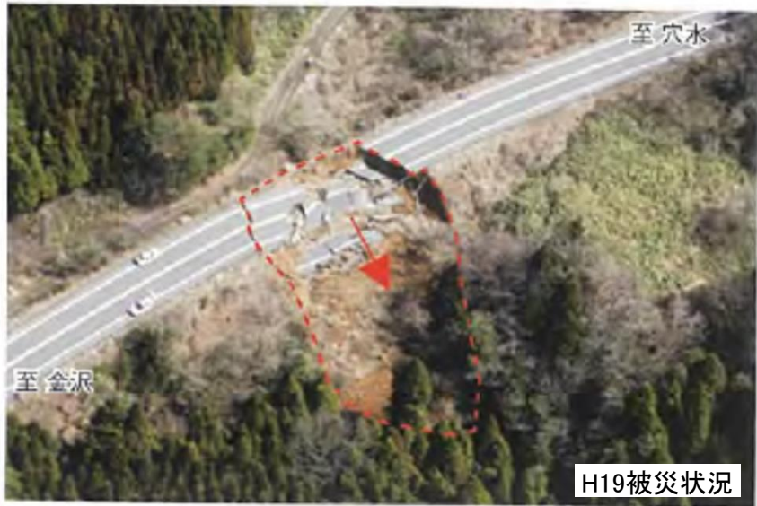
上下線の崩落 (H19.3月)
