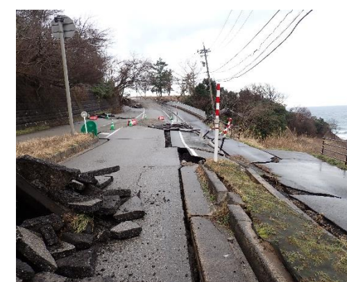
写真10. 拡幅盛土部の路面段差
