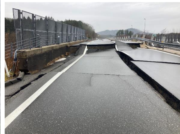
写真5. 路面段差(のと里山海道17.8kp付近)
