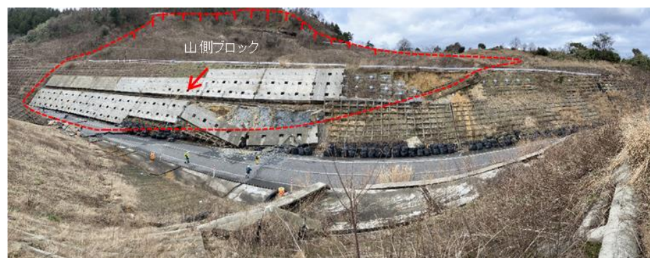
写真4. 鳥川大橋周辺の地すべり(既設アンカー工引き抜け等)
