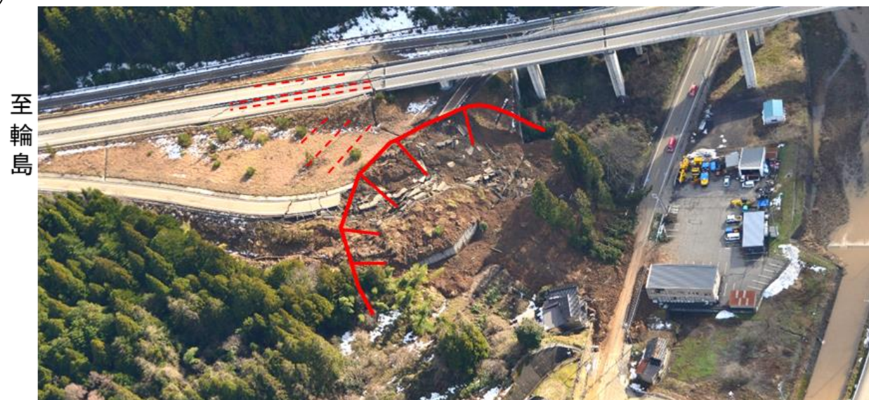
写真1. 盛土崩壊(穴水道路17.4kp付近)
