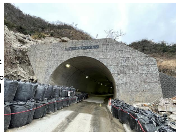
珠洲側坑口；変状あるが軽微
