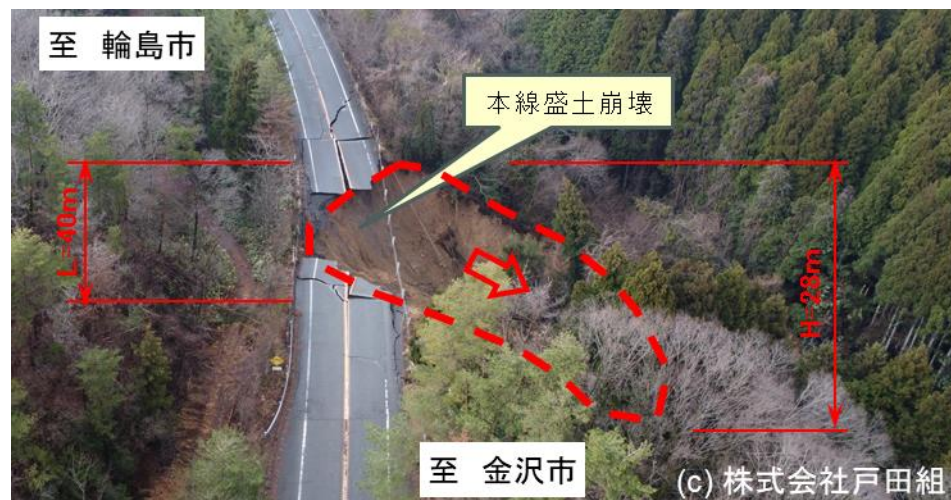
写真2. 盛土崩壊(のと里山海道13.8kp付近) ※2車線とも崩壊
