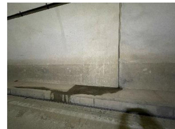
覆工は新規ひび割れ等を確認するも軽微
