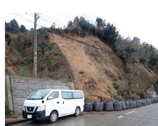
写真9. 風化法面の表層崩壊
