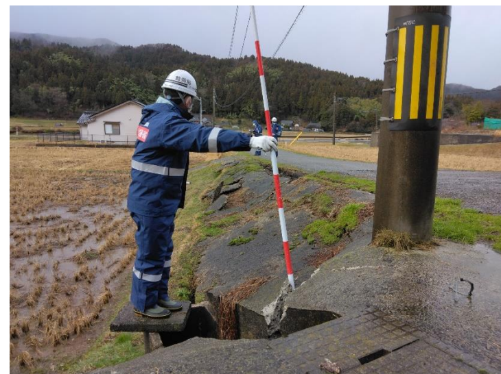
被災状況調査（輪島市下黒川町）
