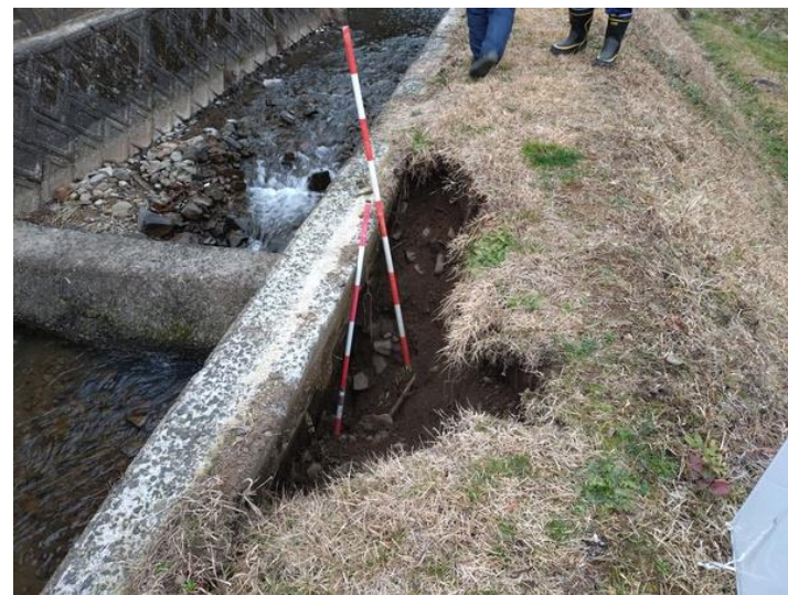
能登町 被災状況調査
