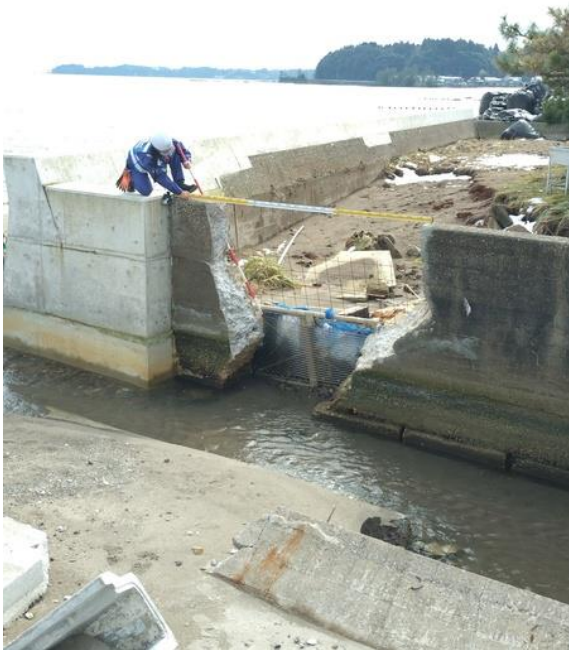
珠洲市 被災状況調査
