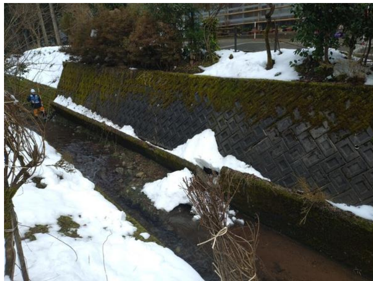
能登町 被災状況調査
