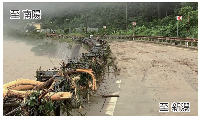
▲令和4年8月豪雨による被災状況
