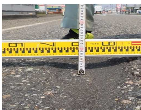
舗装のわだち掘れ
