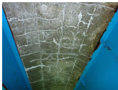
橋の裏面の様子 (床版のひび割れ)
