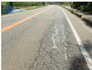
舗装のひび割れ
