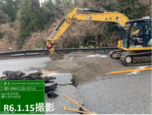
No.56 段差擦り付け
