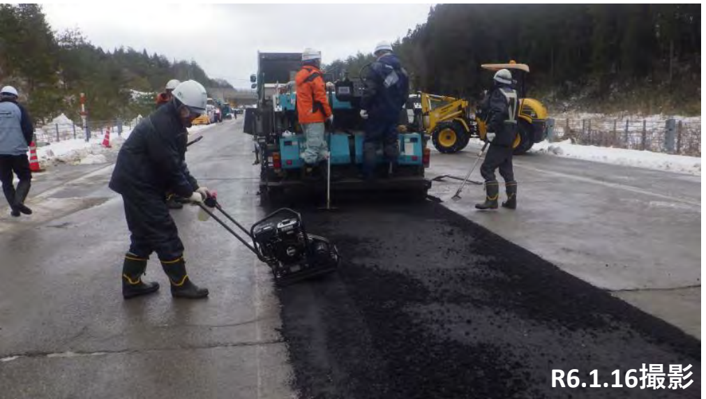
No.6 路面亀裂、段差復旧状況
