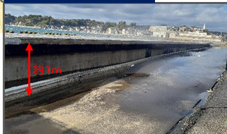
岸壁背後の沈下
