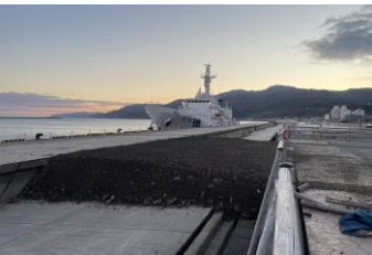
応急復旧の概成状況(5日)
