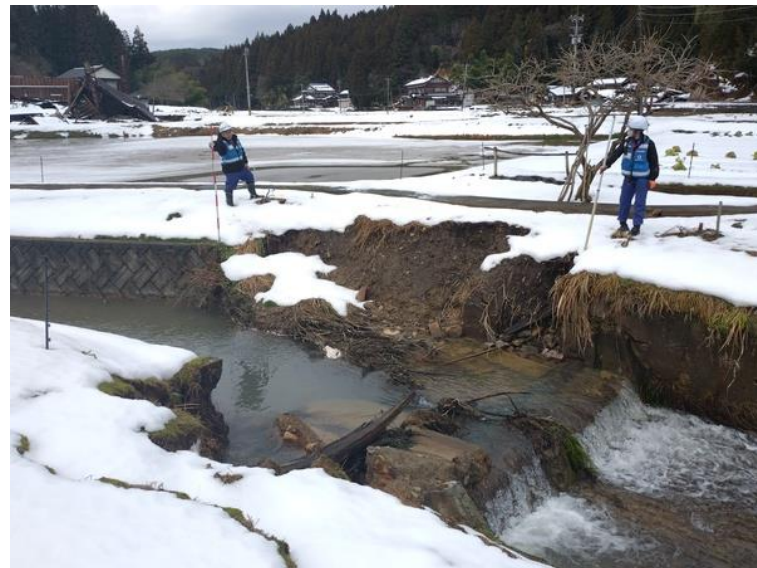
第1班 珠洲市 被災状況調査
