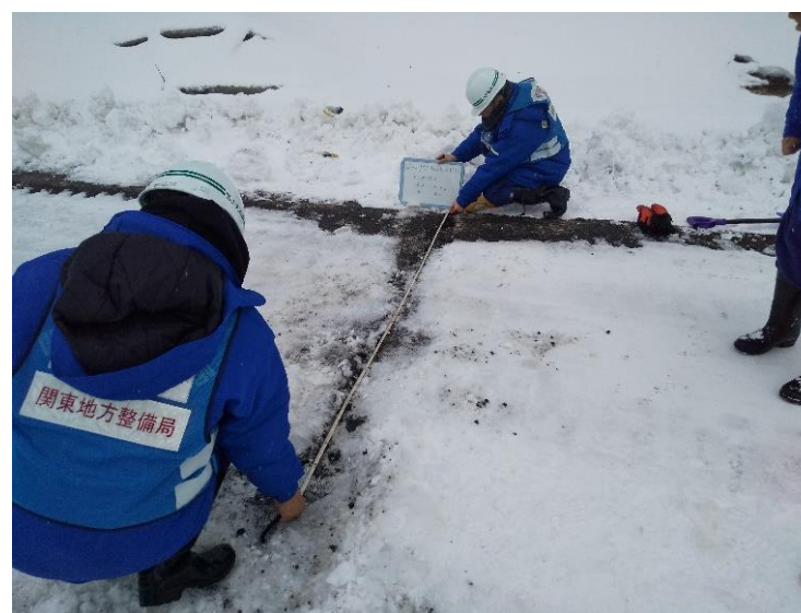
被災状況調査(能登町字柳田)
