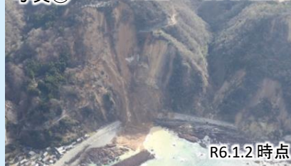
写真④ 国道249号法面崩落
