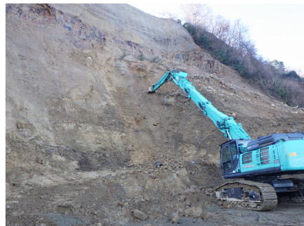
ビル解体用の大型重機による法面中間部の崩落土撤去作業【1/17(水)10時撮影】
