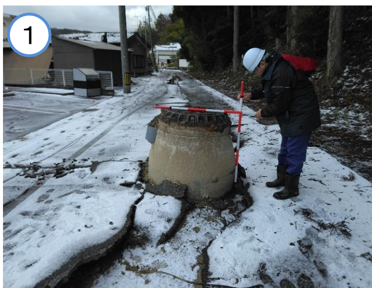
被災状況調査（輪島市山岸町）
