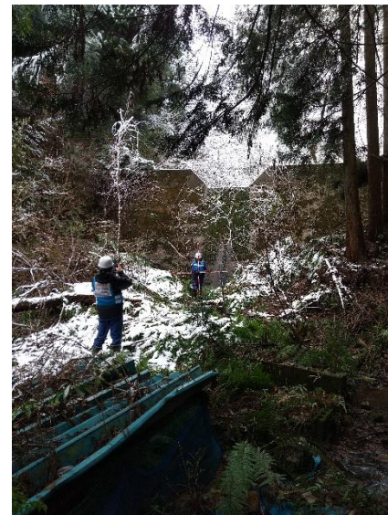
被害状況調査（石川県志賀町酒見）
