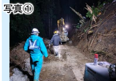
県道38号被害状況
