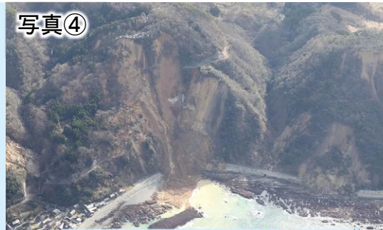
国道249号法面崩落
