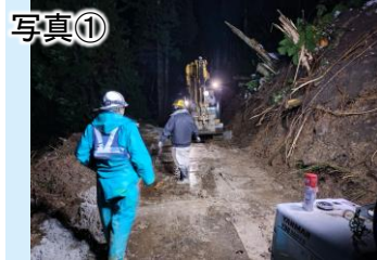
県道38号被害状況
