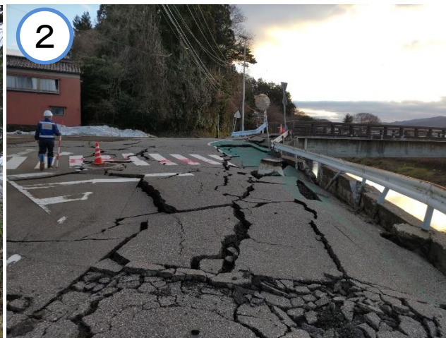
市道 被災状況調査（輪島市鳳至町）
