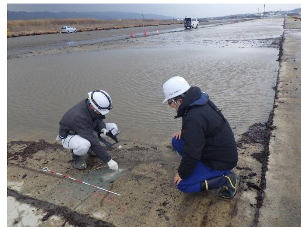
七尾港 被災状況調査
