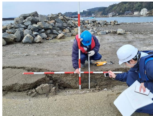
宇出津港 被災状況調査
