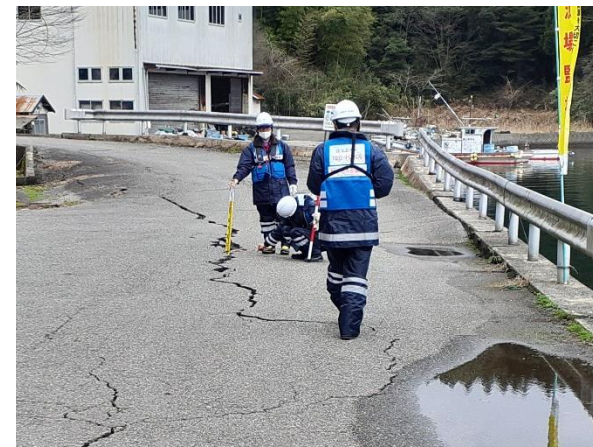
穴水港 被災状況調査
