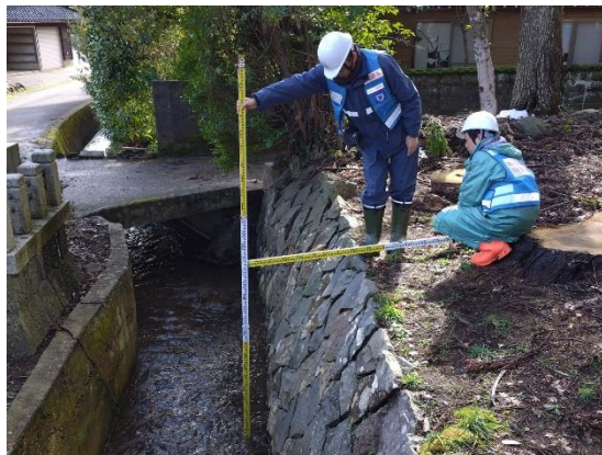
第3班 志賀町護岸被災状況調査
