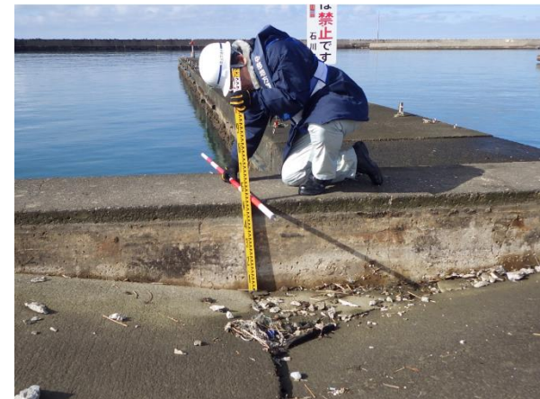
滝港 被災状況調査
