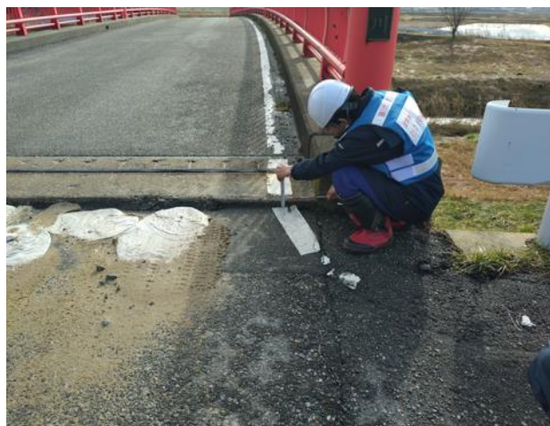
第5班 中能登町橋梁被災状況調査
