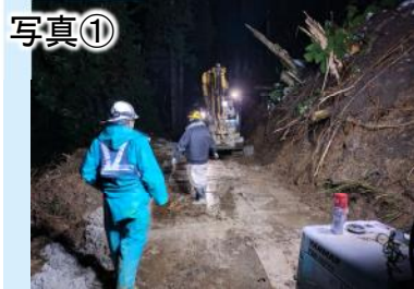
県道38号被害状況
