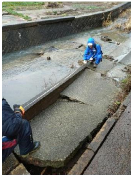
第2班 能登町護岸被災状況調査
