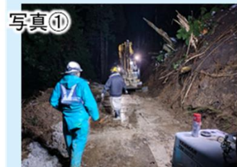
県道38号被害状況
