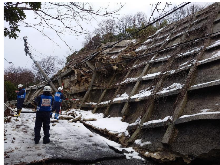
被害状況調査(石川県輪島市稲舟町)
