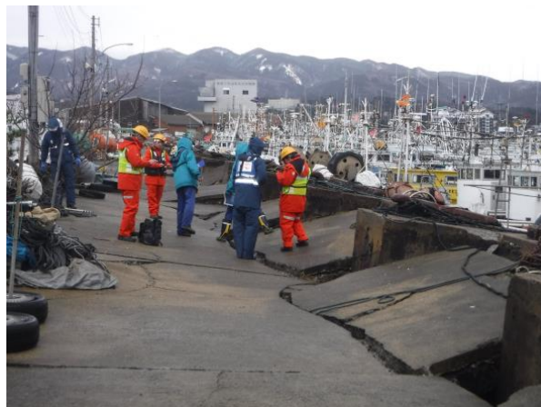
輪島港 被災状況調査
