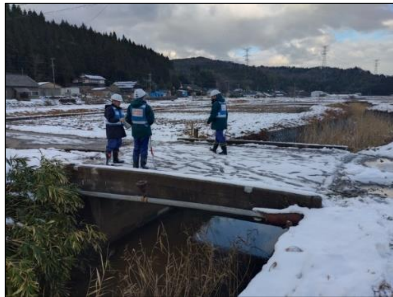
第5班 中能登町橋梁被災状況調査
