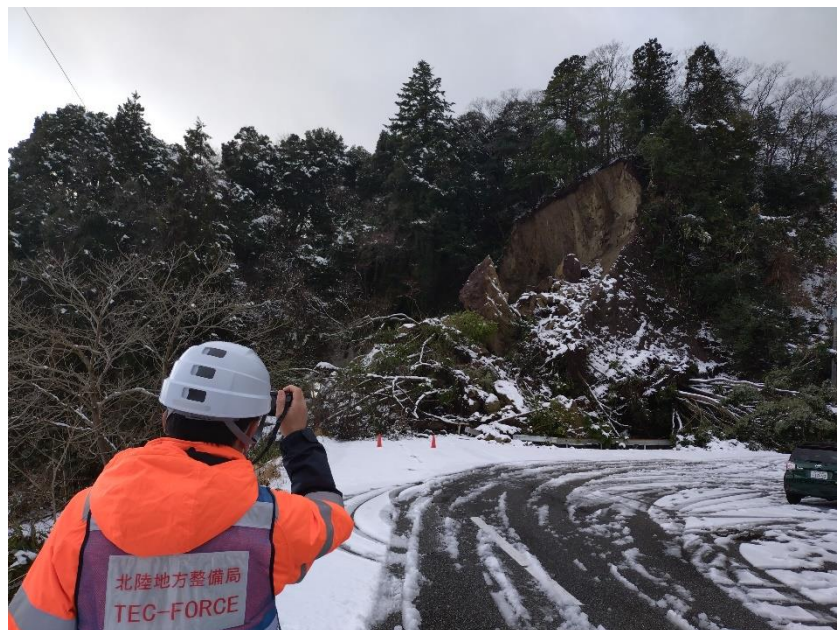
土砂崩落箇所調査状況 (能登町宇出津源平地先)
