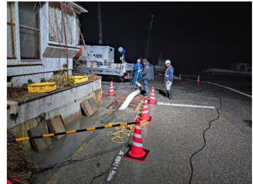
排水ポンプ車稼働
