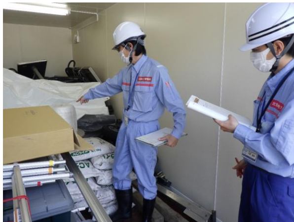
【災害用保管資材の確認】 備蓄倉庫の資材をリスト表と照合し点検
