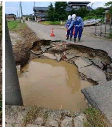
②山口地区 路肩損傷箇所
