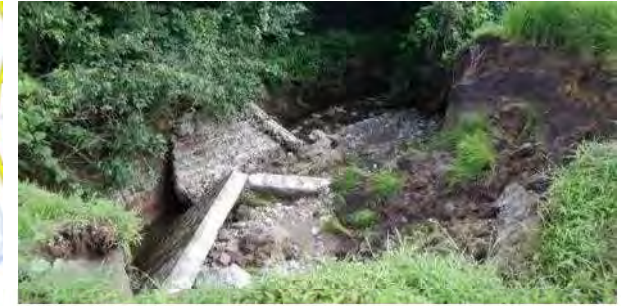
①滝原付近の沢 護岸崩落箇所
