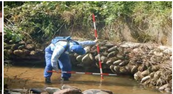
⑤田美ナ口沢 護岸損傷箇所
