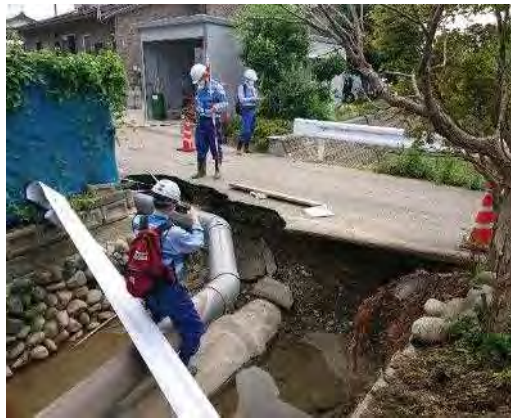
①中倉地区 路肩損傷箇所
