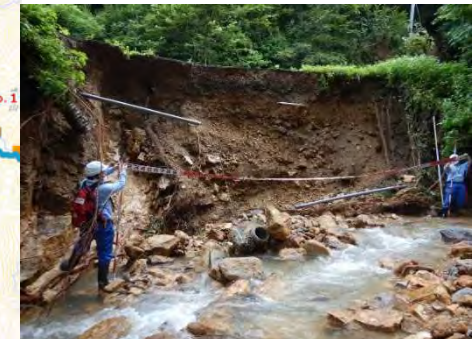
② 斜面の崩落状況を確認
