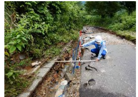
③ 路肩の崩落状況を確認
