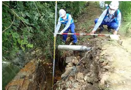
② 護岸の損傷状況を確認
