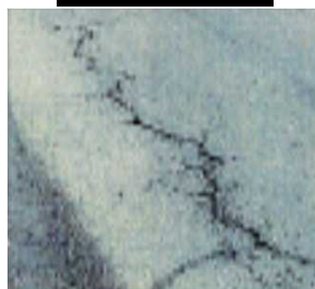
舗装のひび割れ
