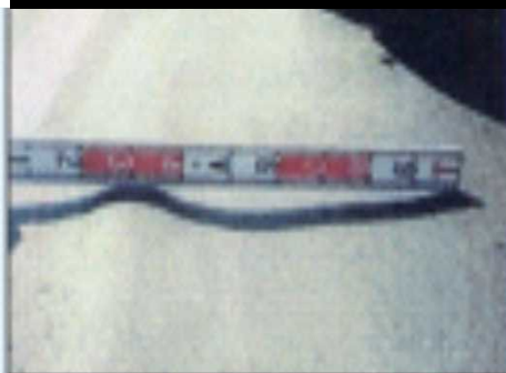
舗装のわだち掘れ
