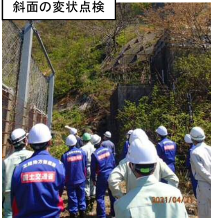
斜面の変状点検
