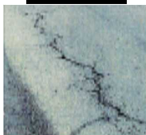
舗装のひび割れ
