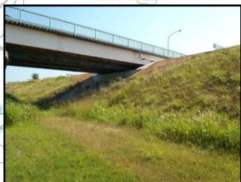
①信濃川大橋左岸 (堤防高(流下能力)、堤防断面不足)
