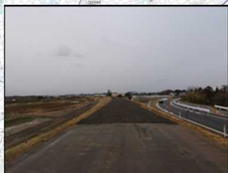
②庄瀬地先(堤防高(流下能力)不足)
