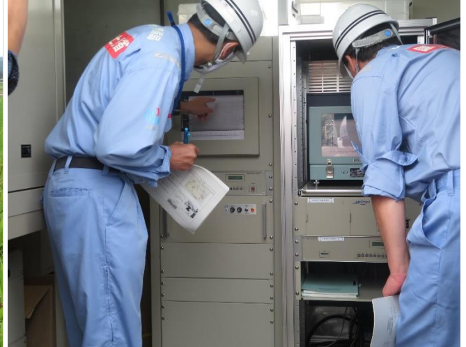
水位データ点検
