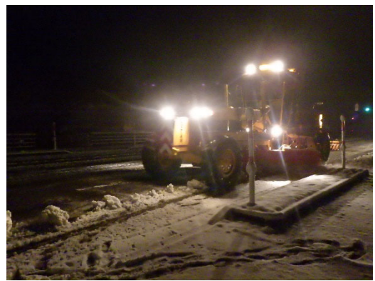
となみしかなや 国道156号 砺波市金屋付近における作業状況
