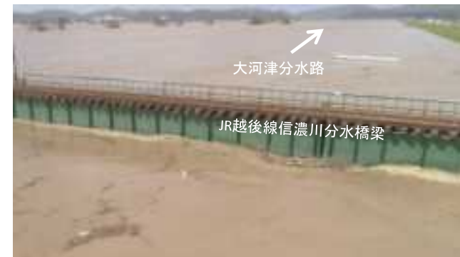
J R 越後線信濃川分水橋梁の橋桁まで 水位が上昇し危険な状況に
