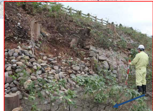
④R30.6k渡場地先 護岸損壊
