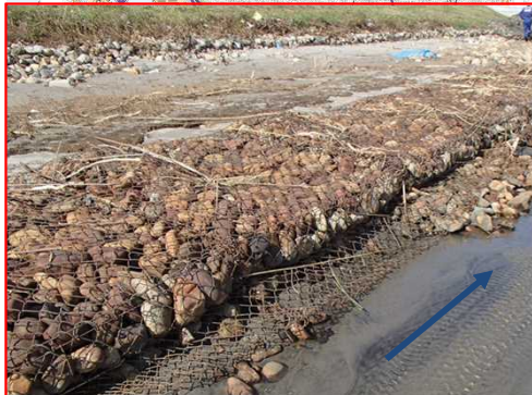
①L0.4k下山地先 護岸損壊
