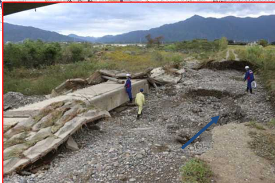
②L28.2k清瀬地先 護岸損壊
