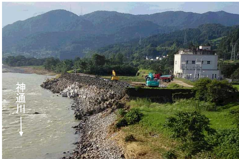
復旧状況（平成30年7月11日 7時00分）
