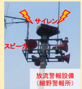
放流警報設備の操作状況
