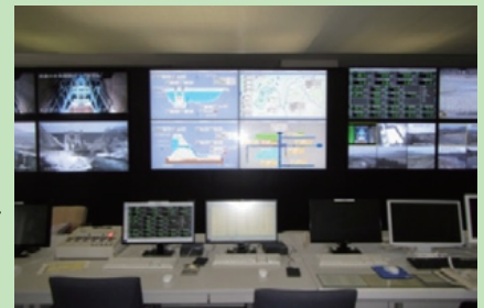
更新後のダムコン（平成28年2月25日）
